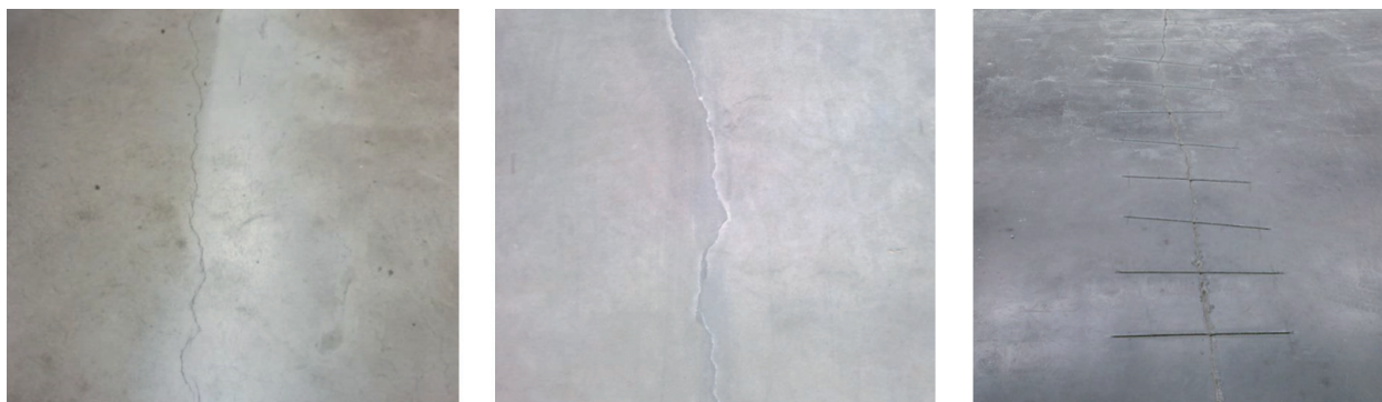
Rys. 2. Kolejno od lewej: pęknięcie pozostawione bez naprawy, wypełnione materiałem elastycznym bez frezowania krawędzi rys i zszyte (Osińska, 2017)
