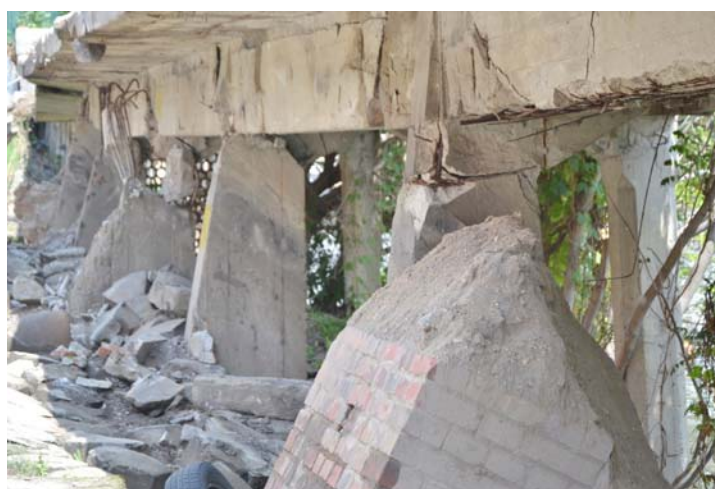
Rys. 10. Przykłady zniszczeń konstrukcji żelbetowych: a – zagłębienie estakady w górnym odcinku osuwiska (wyparte trzy brusy ścian szczelnych utraciły podparcie górą z powodu skorodowania oczepu); b – stan konstrukcji pomostu z widocznymi ubytkami zbrojenia
