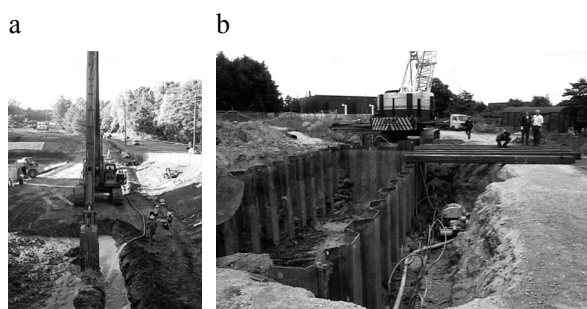
Rys. 2. Wykop zabezpieczony biopolimerem – instalacja bariery z żelaza zero-wartościowego w Marietta, GA, USA (Geo-Solutions, 2017) – a; ścianki szczelne wykorzystane podczas instalacji PBR w Sønderlø, Dania (RTDF, 2001) – b
