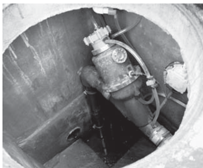
Rys. 1. Wnętrze studzienki żelbetowej z zaworem opróżniającym typu ISEKI
