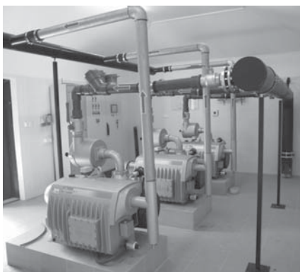
Rys. 2. Wnętrze stacji próżniowo-pompowej Fig. 2. The interior of vacuum-pump station
