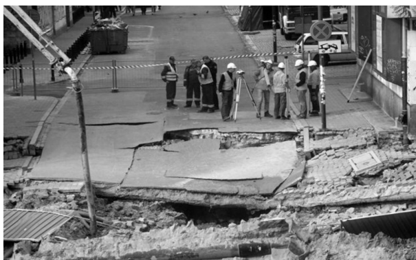
Rys. 2. Zniszczenia w rejonie zalanego wykopu fundamentowego (fot. http://warszawa.wyborcza.pl/warszawa/1,34889,12626718 )
