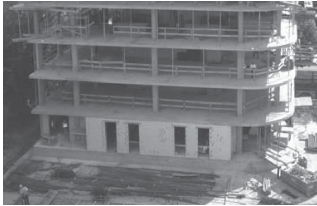
Rys. 1. Płytko-słupowa konstrukcja budynku mieszkalnego wielorodzinnego Fig. 1. Slab-column structure of a multi-family building
