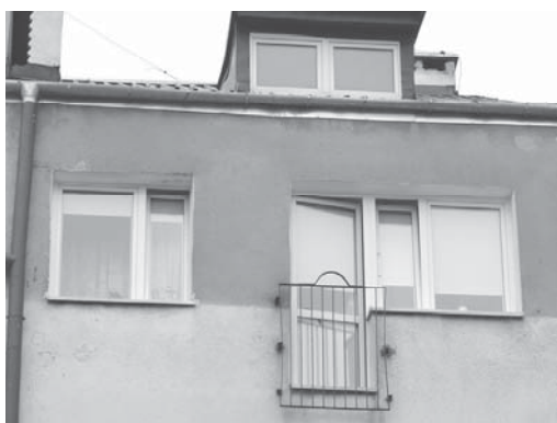
Rys. 4. Widoczne ślady zawilgocenia powierzchni ściany zewnętrznej nad otworami okiennymi oraz brak osłoniętych otworów w kominach
