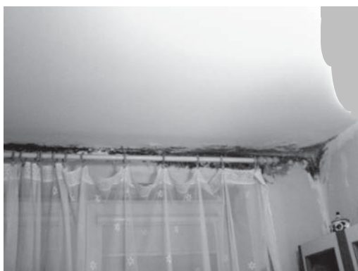
Rys. 3. Widok wilgotnej powierzchni styku nadproża i stropu oraz ściany przyległej do klatki schodowej
