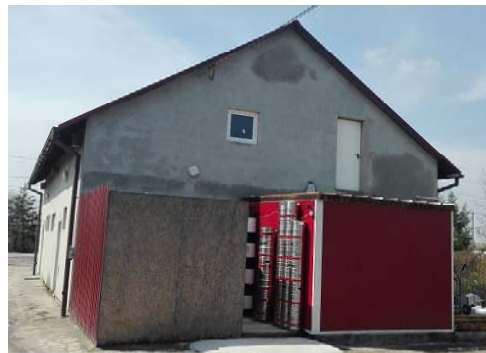
Rys. 6. Widok od tyłu – widoczne wiaty niezwiązane trwale z gruntem (fot. W. Chojecki)
