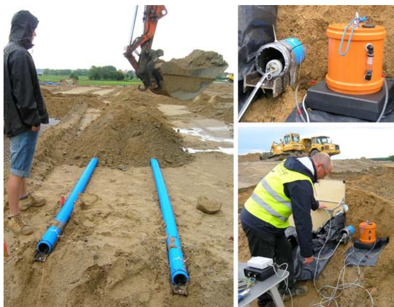
Rys. 7. System pomiaru osiadania nasypu
