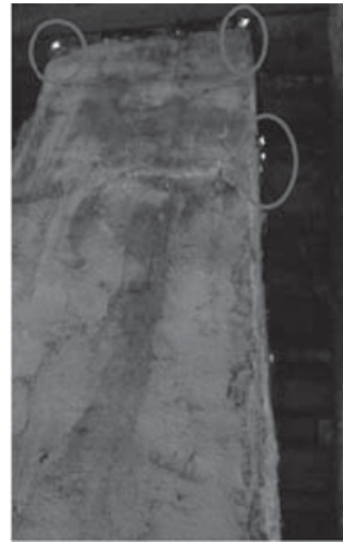
Rys. 2. Widoczny zły stan techniczny pokrycia dachowego Fig. 2. Visible poor technical condition of the roofing
