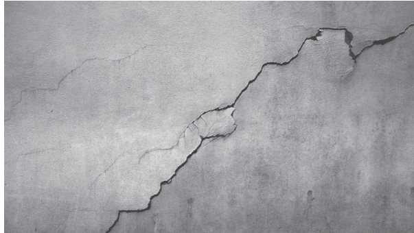
Rys. 1. Zarysowania ścian niekonstrukcyjnych wynikające z deformacji elementów ustroju nośnego
