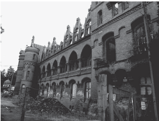
Rys. 2. Sokołowsko, pierwszy wielki budynek sanatorium przeciwgruźliczego dr. H. Brehmera – powojenna nazwa „Grunwald” (fot. E. Gonda-Soroczyńska, 2010)
