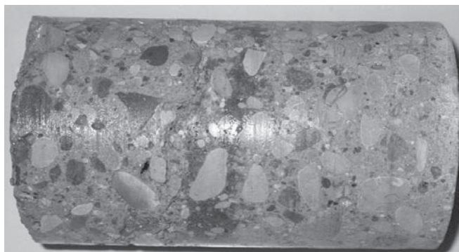
Rys. 3. Rozwarstwienie betonu w warstwie podłogi – złe zagęszczenie Fig. 3. Concrete fracture in the floor layer – bad concrete consolidation
