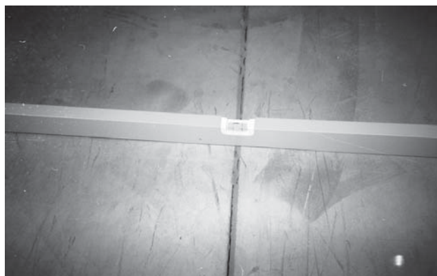
Rys. 4. Zbyt późne wypełnienie szczelin dylatacyjnych – wywijanie krawędzi płyt Fig. 4. The expansion gap was filled too late – the plate edges turn up
