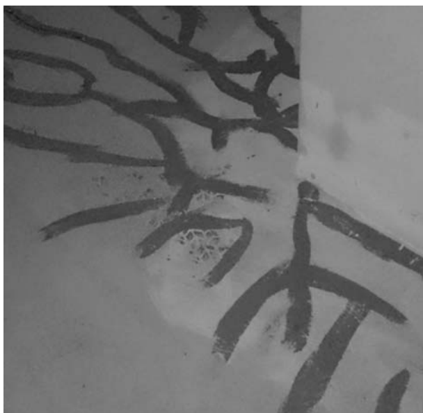
Rys. 10. Widok poszczególnych rys kondygnacji 1 po wykonaniu naprawy (fot. A. Majstrowicz)
