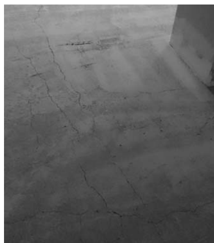
Rys. 9. Widoczne rysy w obrębie słupa na kondygnacji –1 (fot. A. Majstrowicz)
