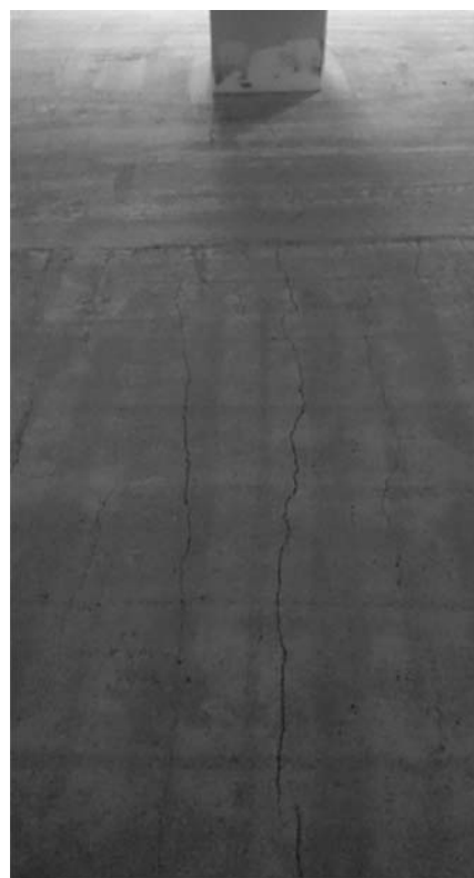
Rys. 8. Widoczne rysy pomiędzy słupami na kondygnacji –1 (fot. A. Majstrowicz)
