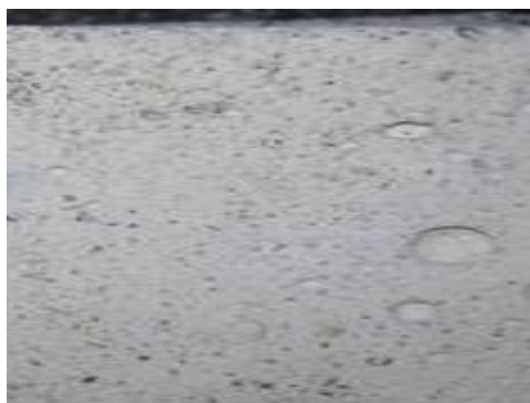
Rys. 4. Powierzchnia próbki niezaimpregnowanej – nieregularna powierzchnia świadczy o ubytkach, które pojawiają się w wyniku ekspozycji na działanie czynnika agresywnego
