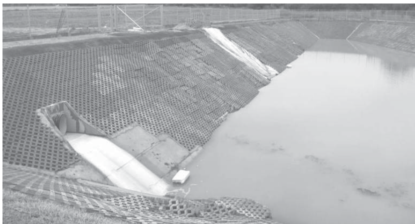
Rys. 3. Widok zbiornika dzień po deszczu nawalnym, przed odpompowaniem wody
