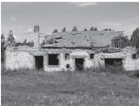
Rys. 6. Przykłady obiektów zdewastowanych: a, b – budynki mieszkalne, c – budynek inwentarski (fot. M. Gorączko)
