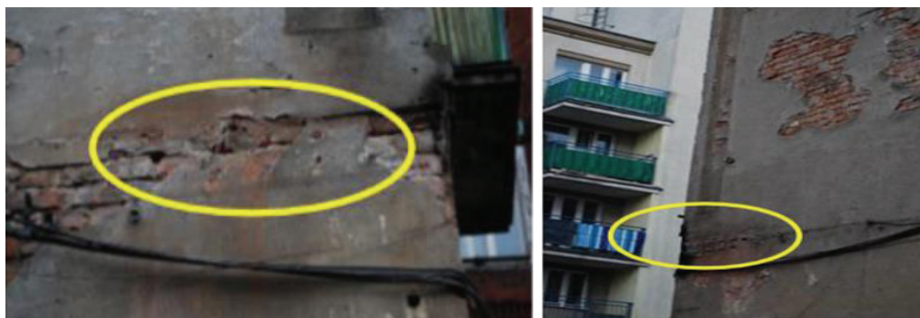
Rys. 5. System ściąгов umieszczone nad lub pod stropami Fig. 5. The system of brace coils above or below the ceiling
